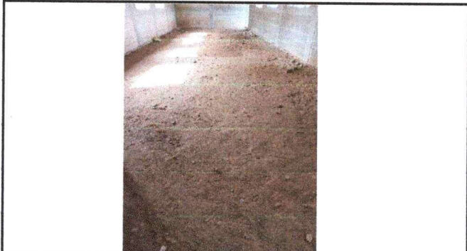
Foto 3: Vista interior de las aulas con piso de tierra necesidad de mantenimiento correctivo.
