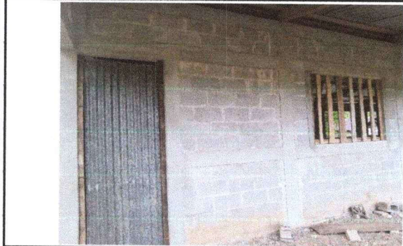
Foto 1: Actualmente hay dos puertas hechas de láminas en dos aulas donde reciben clases los niños y niñas del establecimiento. (parte exterior).
