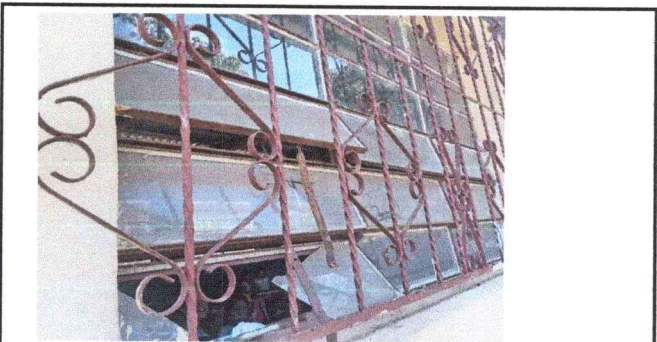
Foto 5: Necesidad de mantenimiento correcto de ventanas y balcones del centro educativo.
