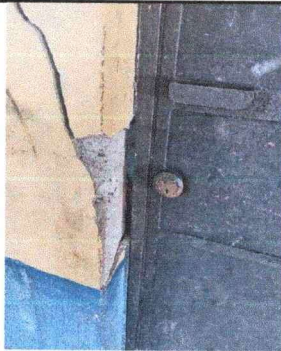
Foto 3: Vista exterior de una de las aulas que requiere servicio de mantenimiento. Impermeabilización de losa (frente del establecimiento)
