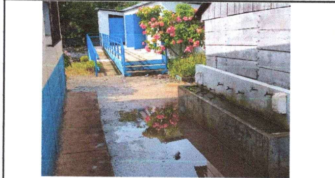
Foto 1: Necesidad de mantenimiento correctivo del lavamano escolar y de la red de agua potable.
