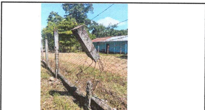
Foto 4: Necesidad de mantenimiento correctivo del muro perimetral del Centro Educativo.
